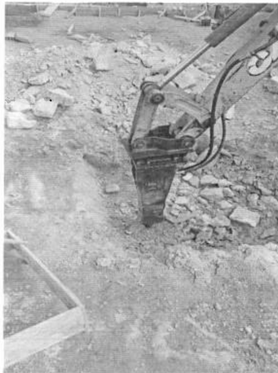
Desmonte de rocha com uso de martelete à percussão de grande porte no Bloco E1.
