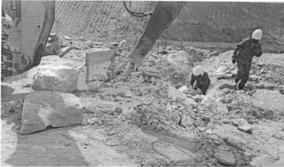
Desmonte de rocha com uso de martelete à percussão de grande porte no Bloco F;
