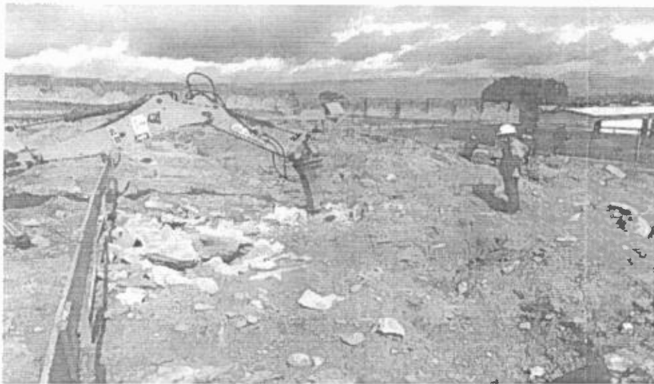
Desmonte de rocha com uso de martelete à percussão de grande porte no Bloco E2.
