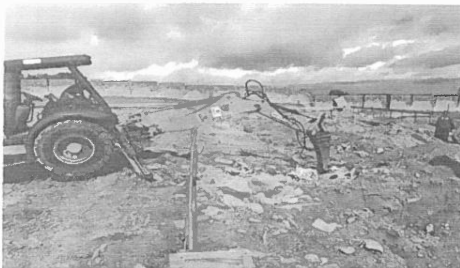
Desmorte de rocha com uso de martelete à percussão de grande porte no Bloco E2;
