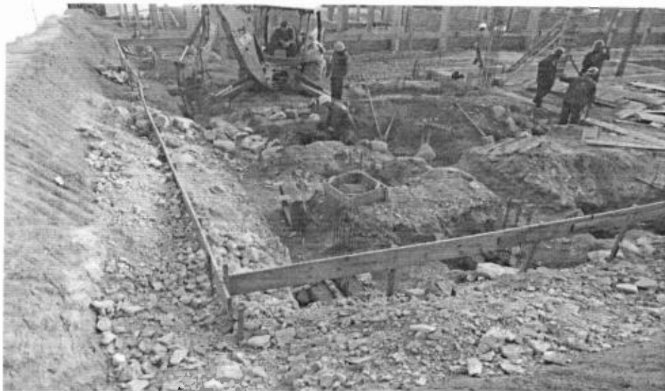
Desmonte de rocha com uso de martelete à percussão de grande porte no Bloco F;
