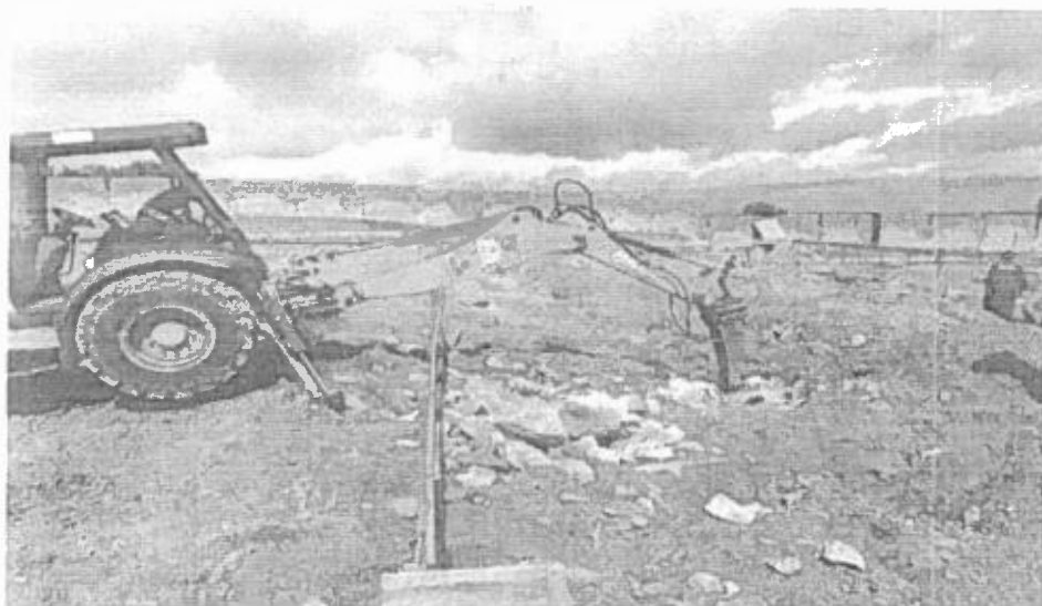
Desmonte de rocha com uso de martelete à percussão de grande porte no Bloco E2;
